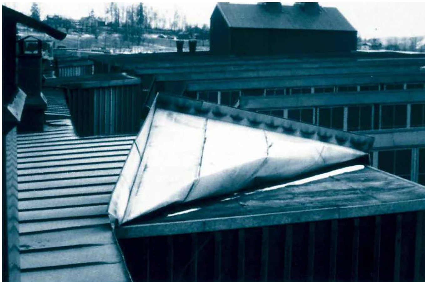
Uszkodzenie nieprawidłowo zamocowanego blaszanego pokrycia dachu spowodowane działaniem siły ssącej wiatru
